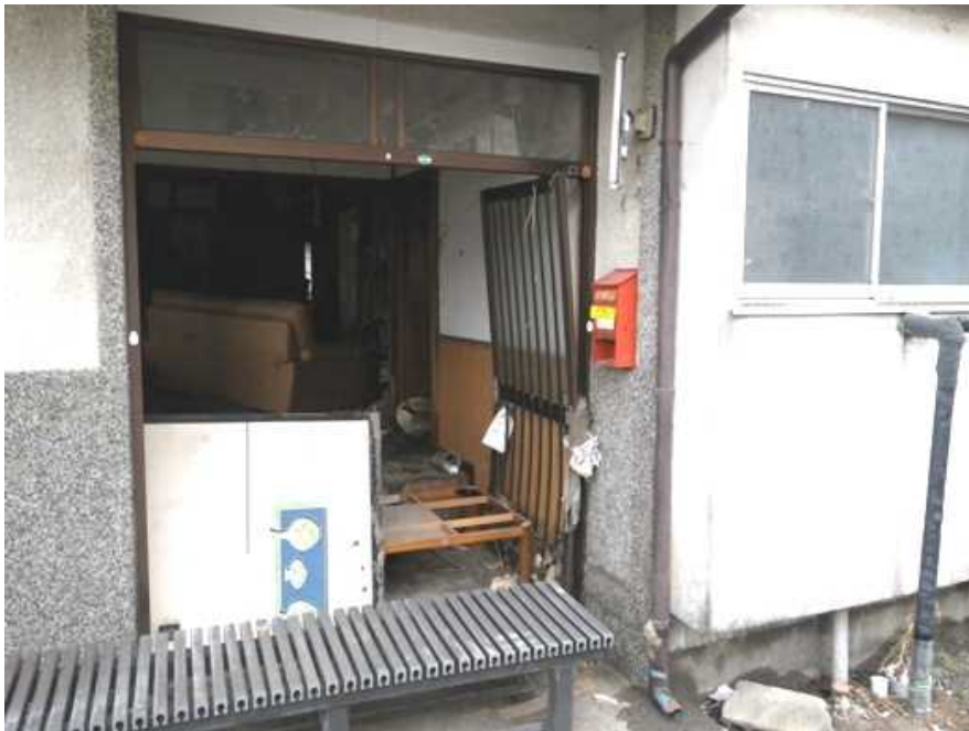
【津波が一階部分に入り玄関と内部が破壊された住宅】
