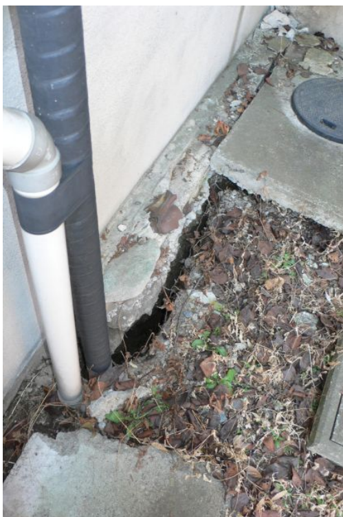
事務所の入口サッシが閉まらなくなった(右)
