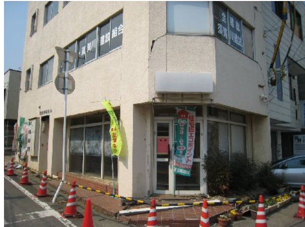
倒壊の危険がある須賀川建設組合事務所
