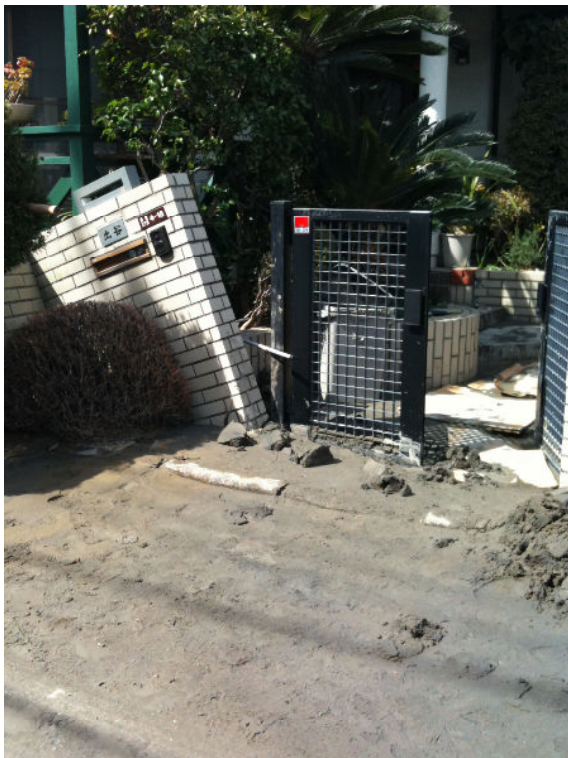
写真左・地盤が緩み門扉が倒壊状態に
